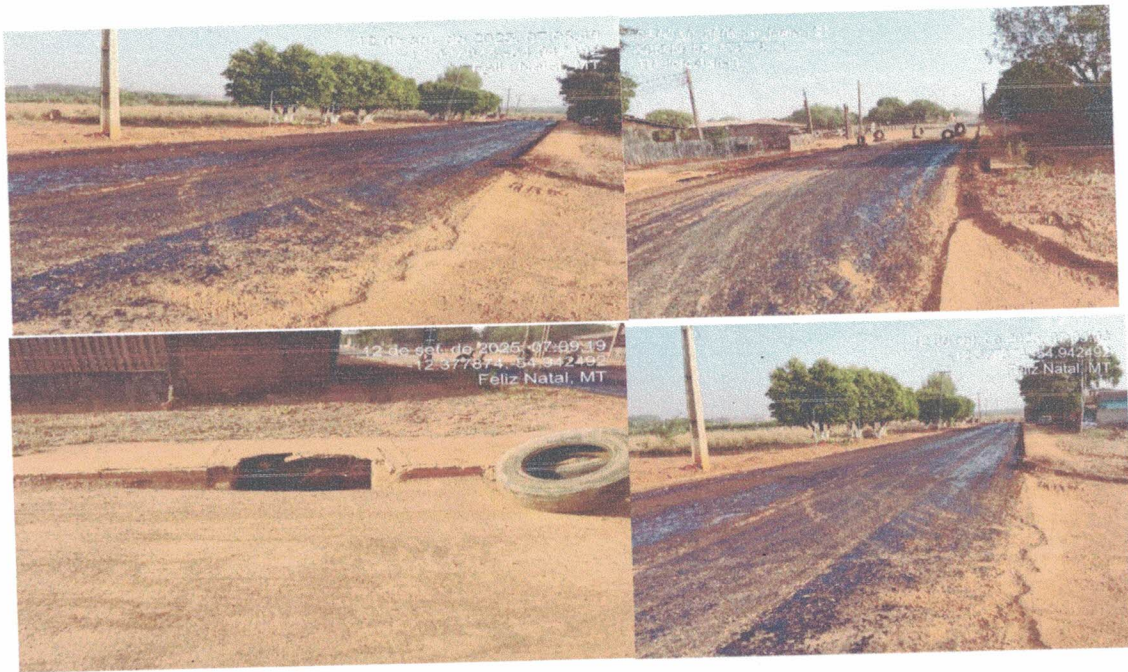
12/09/2025_ Fiscalização da pavimentação da Rua Uruguai e bueiros com falta de manutenção.
